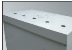
Dachansicht mit vorbereiteten Rohrdurchführungen und Abluftanschluss
